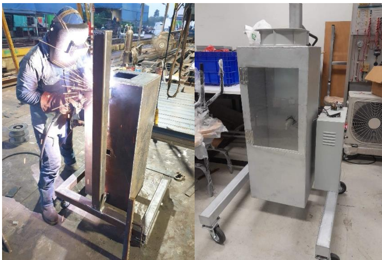
ภาพที่ 3-11 โครงสร้างชุดทดลองการพาความร้อนแบบบังคับ
