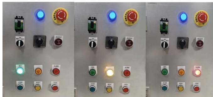
ภาพที่ 4-4 การทดสอบแผงควบคุม
