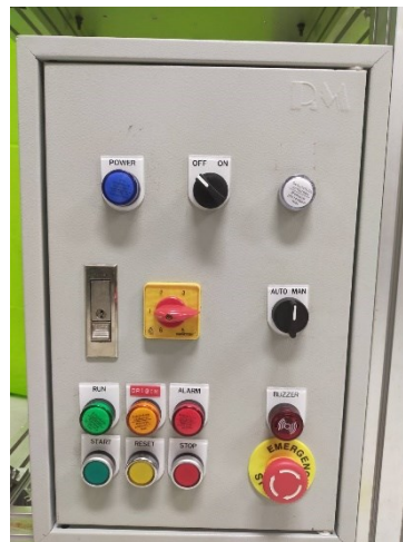
ภาพที่ 3-4 แสดงการติดตั้งอุปกรณ์ที่แผงวงจรควบคุม
